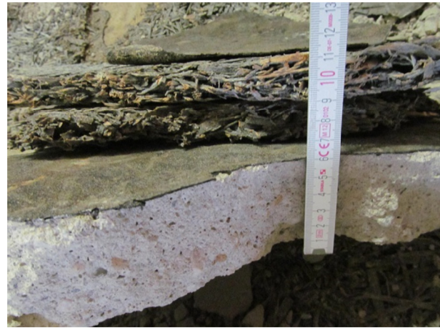
Aufmaß der Fußbodenschichten für die Mengenschätzung, Untersuchung auf Gefahrstoffe, Deklaration für die Entsorgung des Mineralgemisch es
